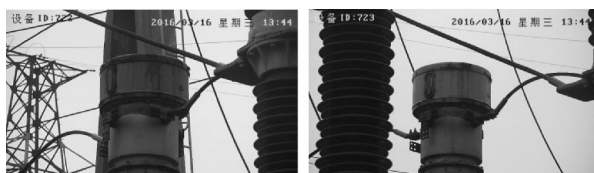
图 29 金属外壳锈蚀
